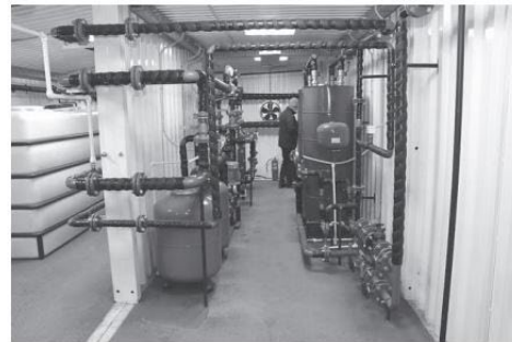
Котельная школы села Мичуринского
